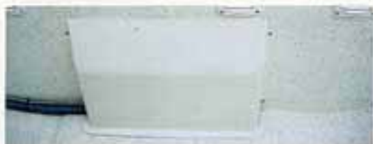
Här bakom skyddskåpan finns ellänsumpen med nivåvakt som ingår i standardutrustningen.
